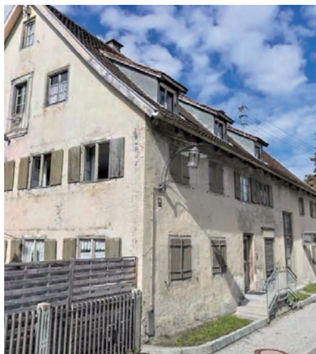
WOHNHAUS OBERER MARKT 48, STARK SANIERUNGSBEDÜRFTIG
