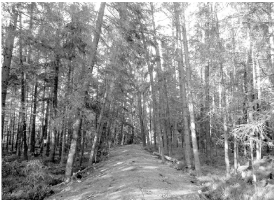
Negativbeispiel: Das hohe Gewicht des Kiesweges drückt die Wurzeln der Fichten in dem weichen Torfboden nach unten; Dadurch neigen sich ganze Stämme zur Wegemitte und stellen eine Verkehrsgefahr dar. Foto: Moorallianz
